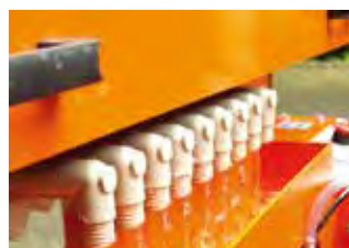
Évacuation de l'eau filtrée
